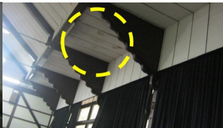
Plafon terkena bocor
